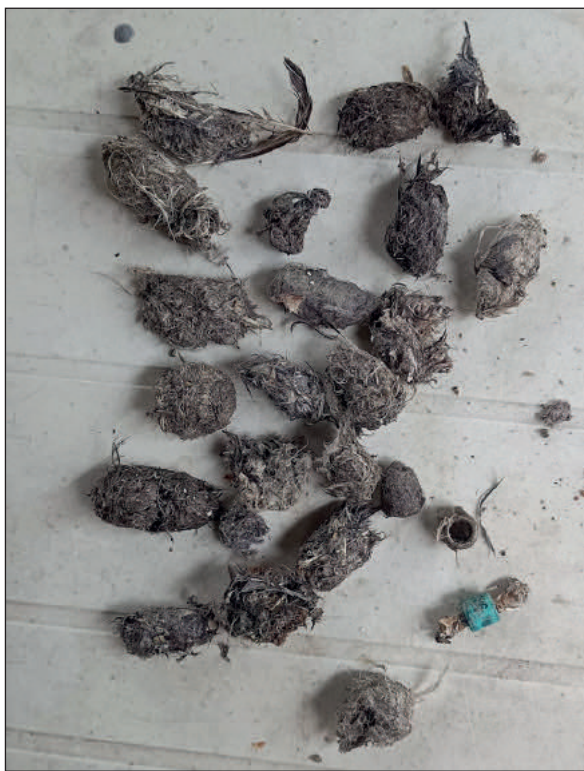
Fig. 9 – Borre raccolte dal pavimento dei balconi, 2023-2026 (foto M. Ferri).
